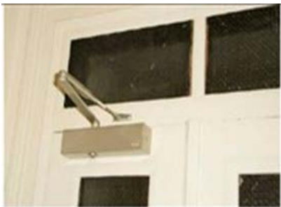
Dørpumpe montert på eldre dør som er oppgradert.
